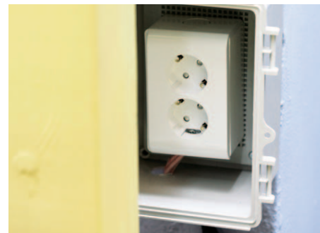
파고라 옆 벽면에는 테이블 위에서 노트북 작업을 할 수 있도록 별도의 조명과 콘센트를 두었다. 감나무 데크 쪽에도 조명과 배선 단자함들을 두어 언제든지 전기를 이용할 수 있도록 하였다.
